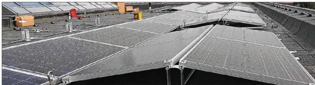
Die Fachdach-Photovoltaikanlage auf dem Burger Schuldach.
